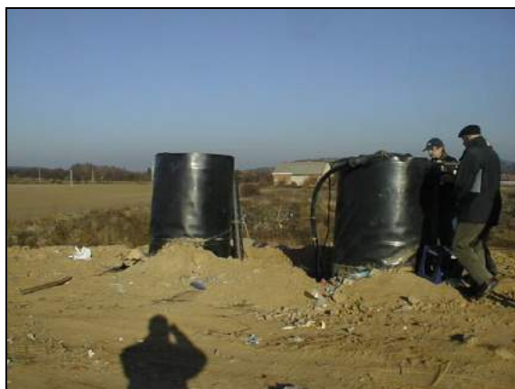
Obr. 3 Dvě čerpací jímky, v zatěsněném prostoru I.etapy
